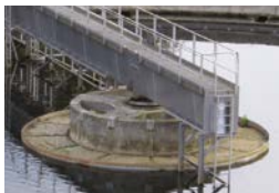
Traitement des eaux usees
